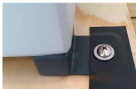
●蓄電池脚部の固定方法事例
