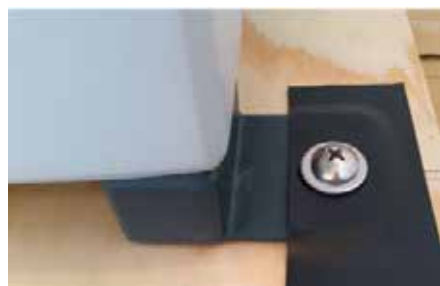
●蓄電池脚部の固定方法事例
