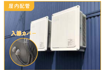
屋内配管 パワーコンディショナへの配管・配線が壁内を通ります。
