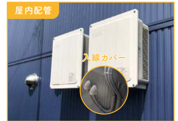
屋内配管 パワーコンディショナへの配管・配線が壁内を通ります。
