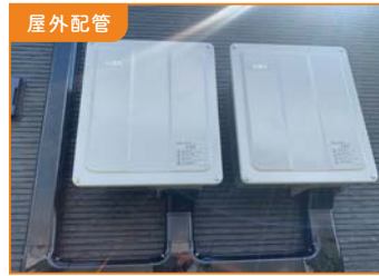
屋外配管 パワーコンディショナへの配管・配線が外壁材の外側を通ります。
