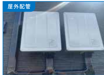
屋外配管 パワーコンディショナへの配管・配線が外壁材の外側を通ります。
