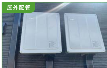
屋外配管 パワーコンディショナーへの配管・配線が外壁材の外側を通ります。
