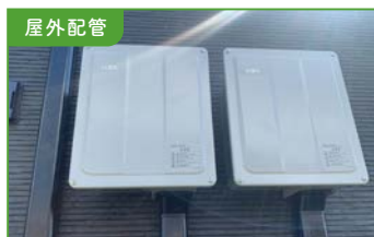
屋外配管 パワーコンディショナーへの配管・配線が外壁材の外側を通ります。
