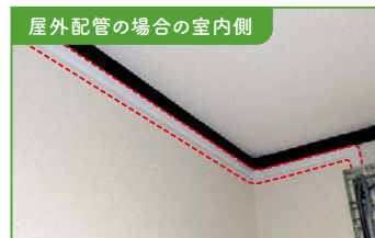
屋外配管の場合の室内側 屋内側の配線が内壁材の外側を通る場合があります。(赤点線部)
