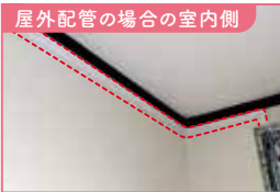
屋外配管の場合の室内側
