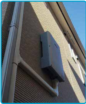
屋外配管事例
